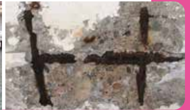
腐食した鉄筋 (日大下田実習所)
